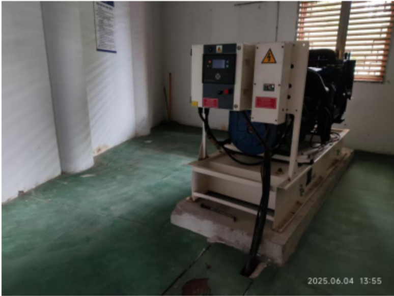
图 4.2-1 柴油发电机房防渗措施
